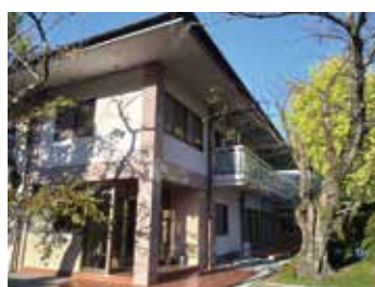
老朽化した银杏会館
